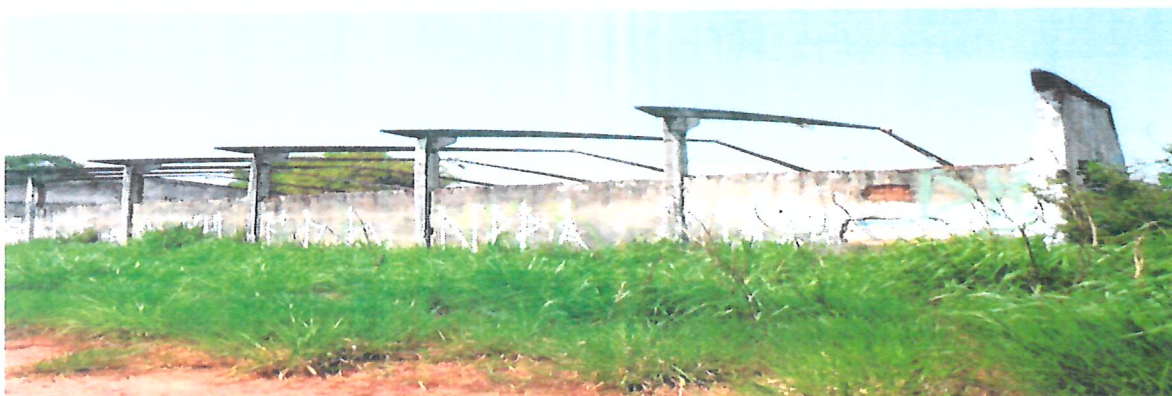
Galpões com estrutura em ruínas
